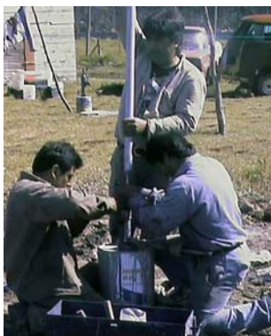
Foto 5: Instalación de bombeo y protecciones.
