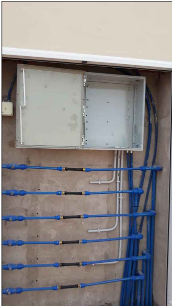
Ejemplo: sala de medición con gabinete eléctrico.
