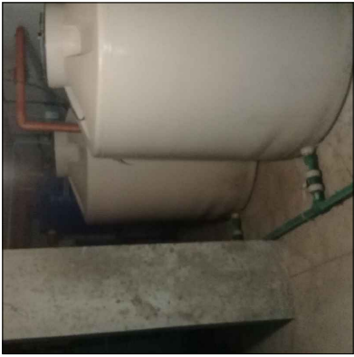
Ejemplo: tanque de reserva.
