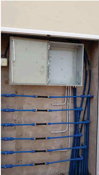
Ejemplo: sala de medición con gabinete eléctrico.
