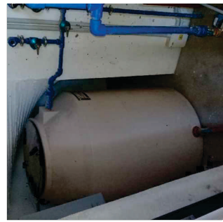
Ejemplo: tanque de bombeo.
