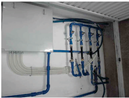
Ejemplo: sala de medición con gabinete eléctrico.
