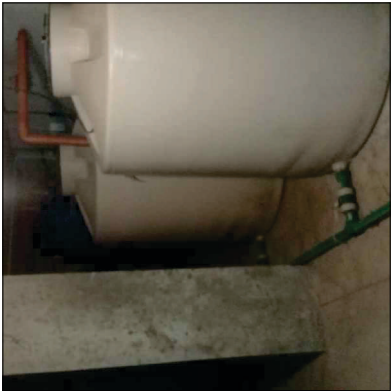
Ejemplo: tanque de reserva.
